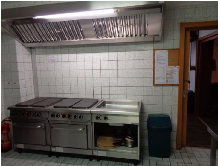
2 x Elektroherd mit je 4 Platten a 3 kw + jeweils Backofen
