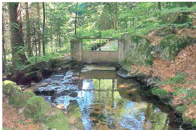
Ableitung mit „Stellfalle“
